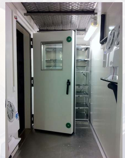
Blick vom Schleusenraum (-20°C) in den Lagerraum (-80°C)
