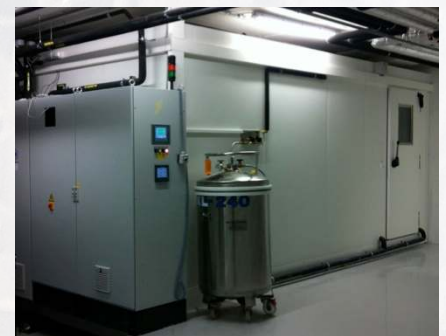
Walk-in Sample Store Gesamtansicht
